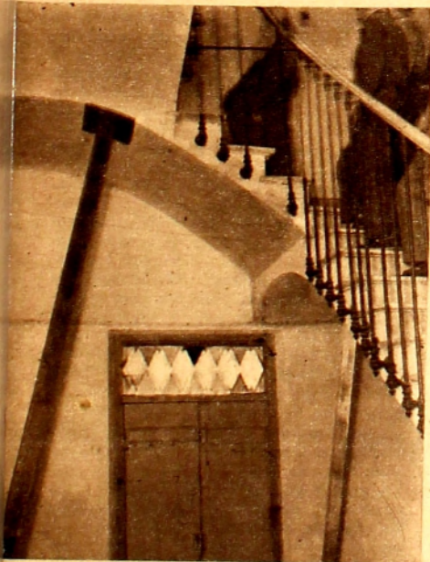
Sobre ser absolutamente inapropiado a los fines de la enseñanza industrial, el edificio propio en el que funciona, necesita urgentes reparaciones de fondo. He aquí la escalera de acceso al primer piso que amenaza desplomarse en cualquier momento.
