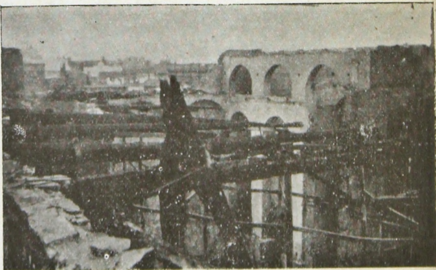
Las vigas del techo reducidas á carbones
